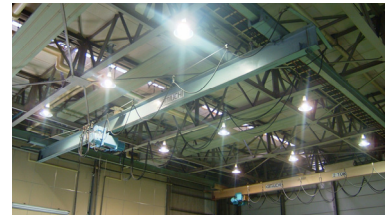
LED照明、高効率照明への変換
