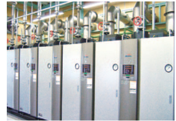
小型貫流ボイラー（鴻巣工場）
